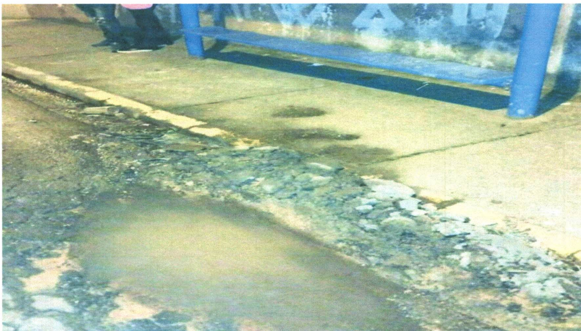
MANUTENÇÃO ASFÁLTICA NA RUA MARTINEZ CASA NOVA EM FRENTE A CRECHE CRISTO MISERICORDIOSO, JARDIM SANTA TEREZA – MOGI DAS CRUZES.
